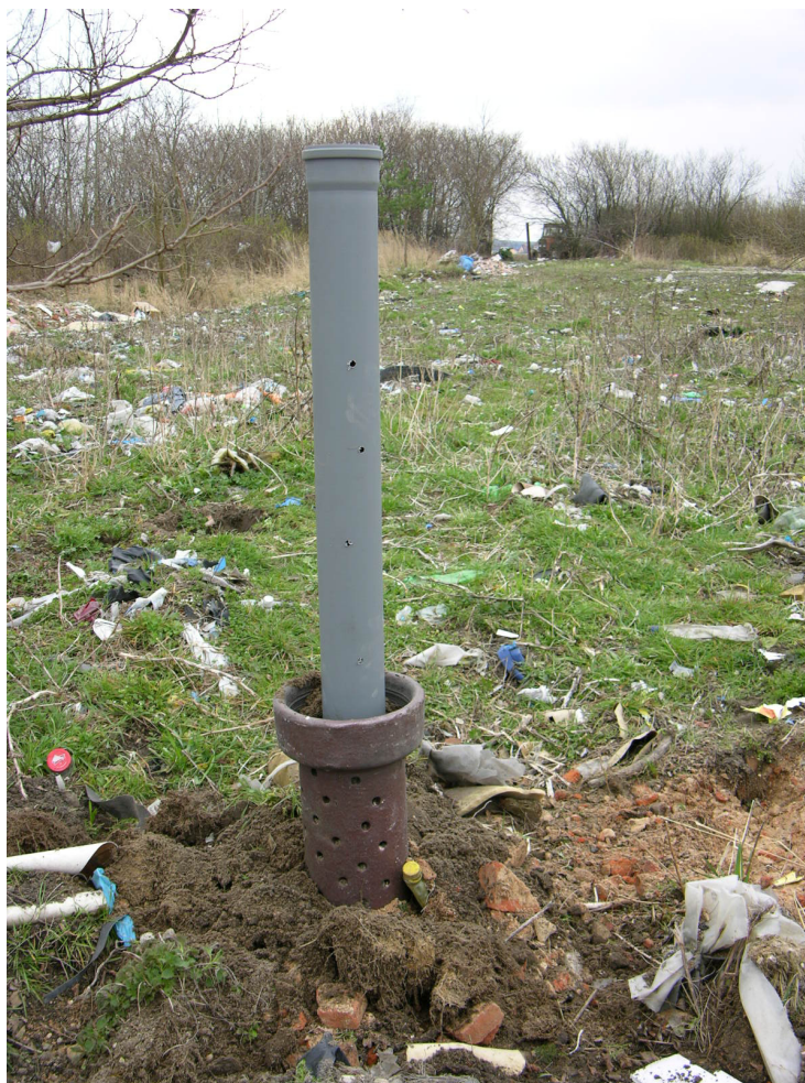
Fot. 5 Studnia odgazowania nr 1
