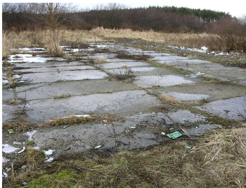
Fot. 8. Plac manewrowy przeznaczony do usunięcia
