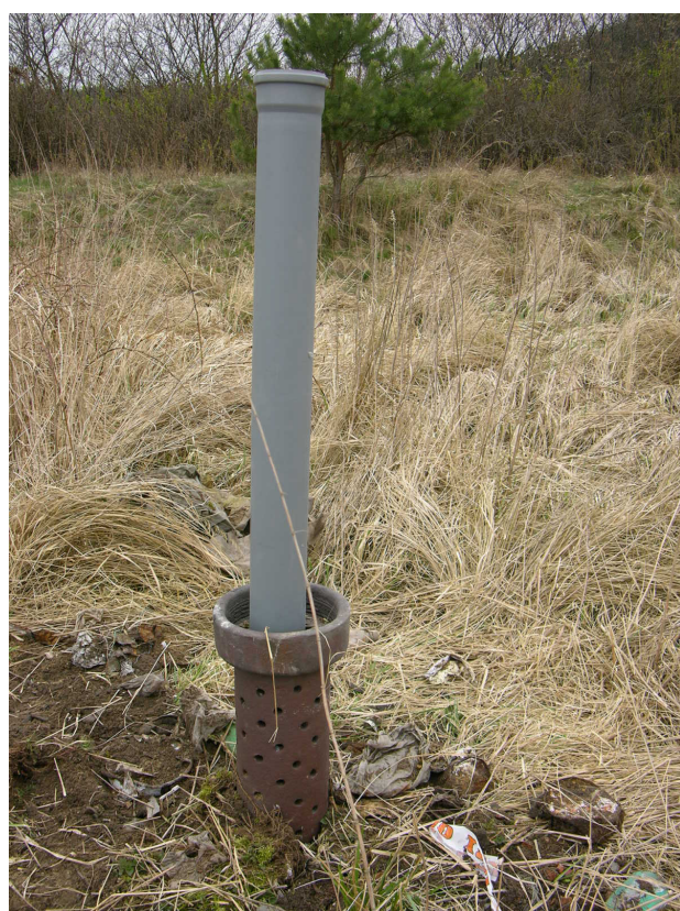
Fot. 6-7 Studnie odgazowania nr 2 i 3
